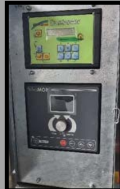
INTERFACCIA CON CENTRALINA IRRIGATORE E CONTROLLO GSM
