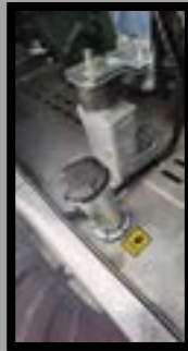
PROLUNGA SU BOCCHETTONE SERBATOIO
